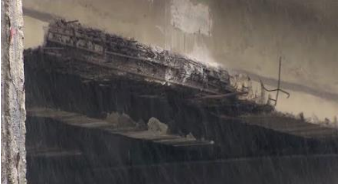
Figura 10 - Corrosão, fissuração e eflorescência na ponte Presidente Jânio Quadros
