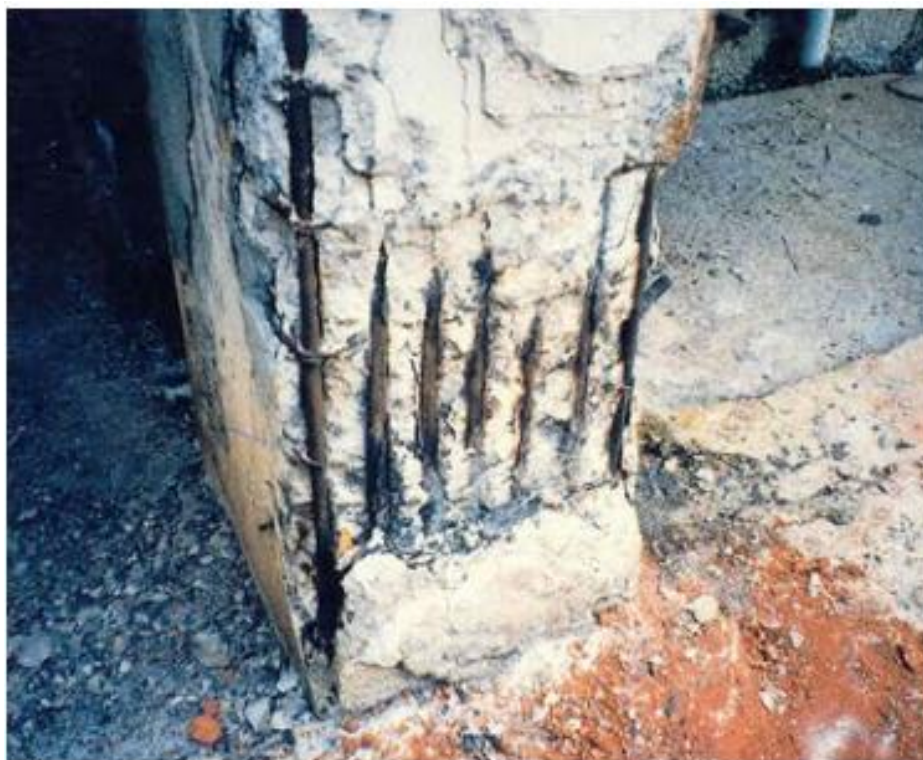
Figura 2- Corrosão da armadura de um pilar
