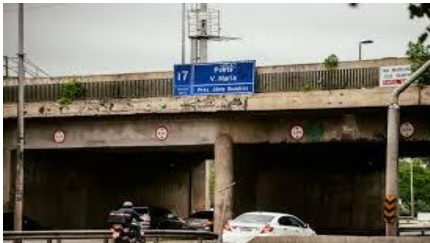
Figura 11 - Eflorescência na ponte Presidente Jânio Quadros
