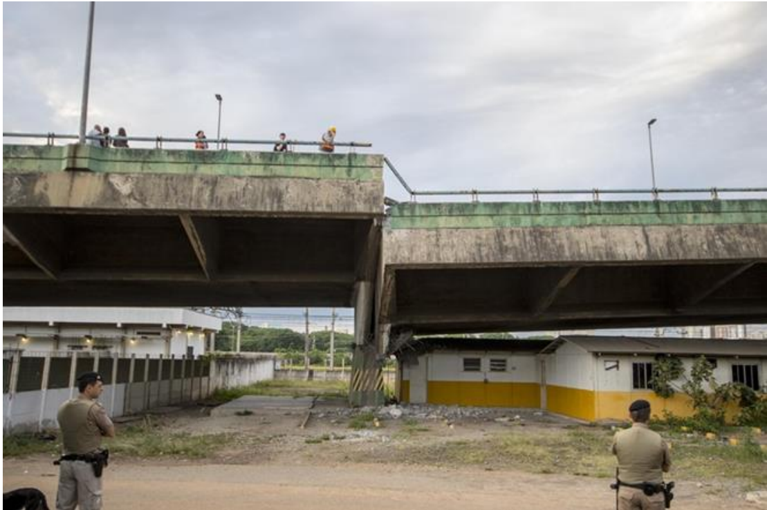
Figura 6 - Desnível na ponte do Jaguaré pós colapso
