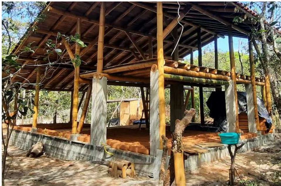
Figura 56 - Cabana Belchior (Pilares de concreto expostos).
