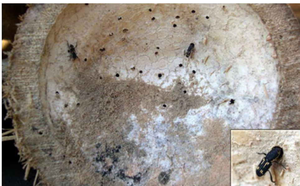
Figura 9 - Bambu com presença de insetos/fungos.
