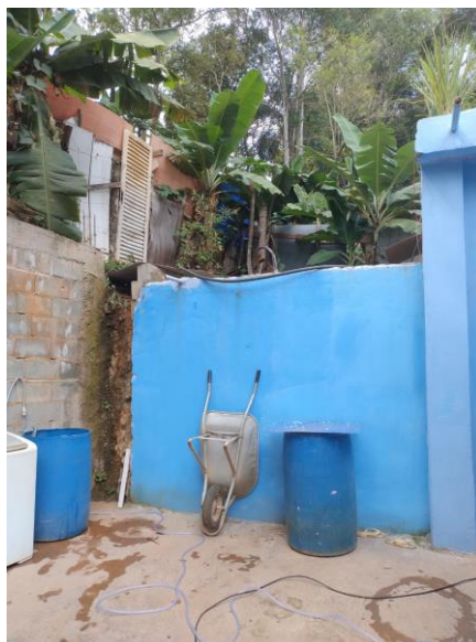
Figura 33- Reservatório domiciliar de água construído em tijolos de forma improvisada, acrescentando-se os reservatórios em tambor plástico
