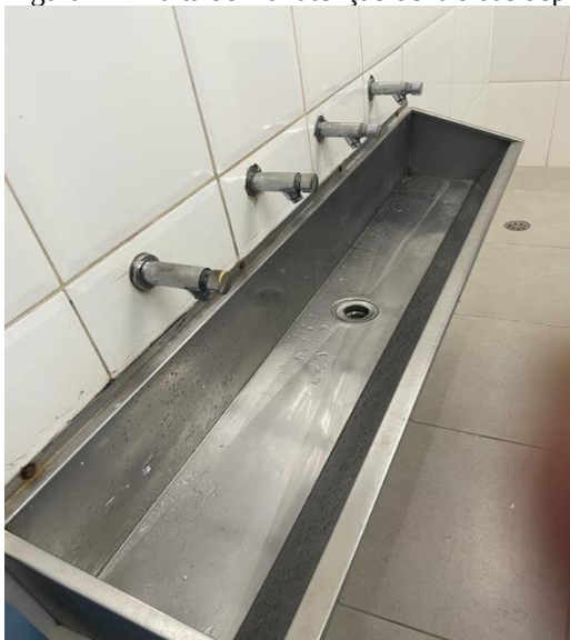
Figura 44 - Falta de manutenção dentro das dependências da Escola
