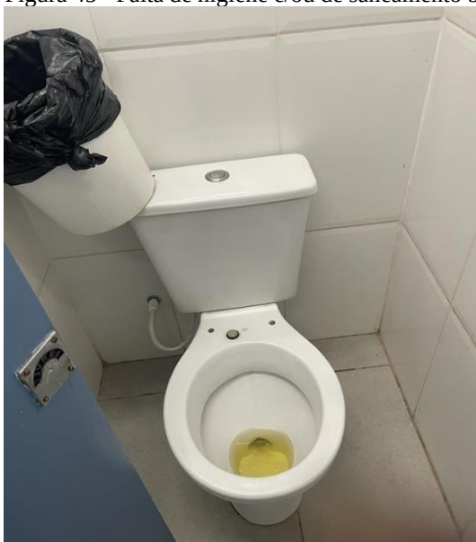
Figura 45 - Falta de higiene e/ou de saneamento básico
