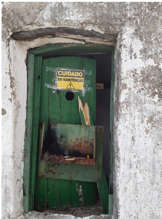
Figura 28 - Capela com a porta danificada em manutenção
