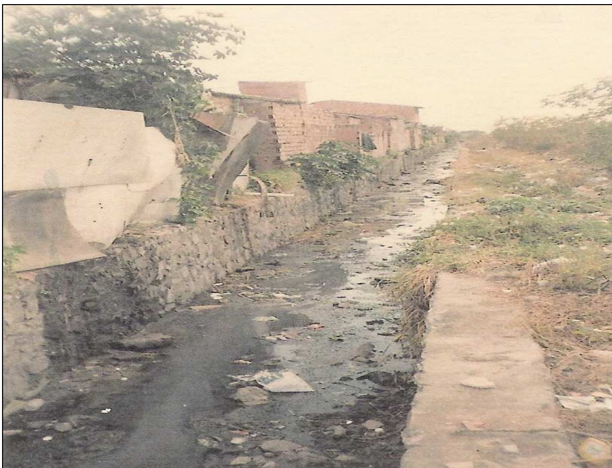
Figura 62. Invasão Renascer – esgoto lançado sem tratamento no canal próximo à localidade. Fonte: Seplan, 2001.
