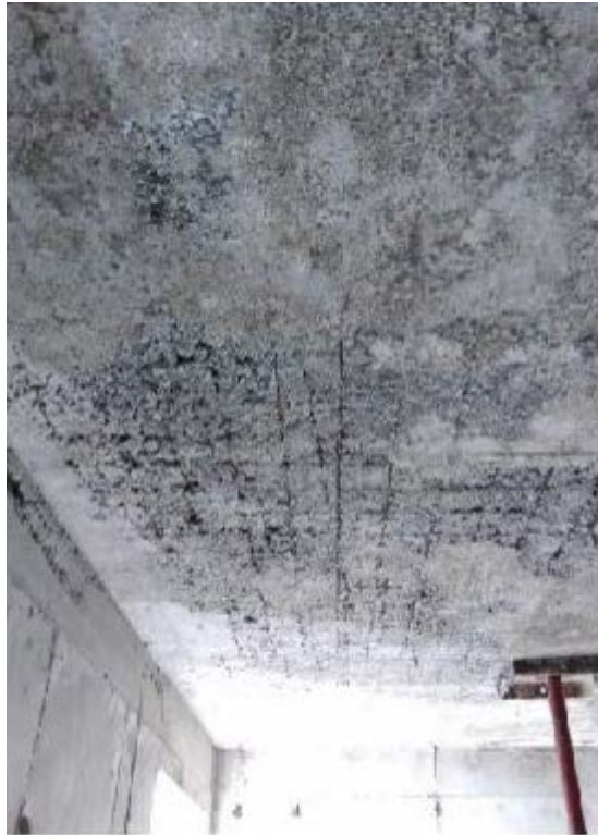
Figura 11 - Armaduras da laje e parede exposta
