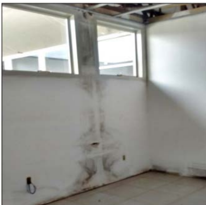
Figura 35 - Juntas mal feitas mofadas;
