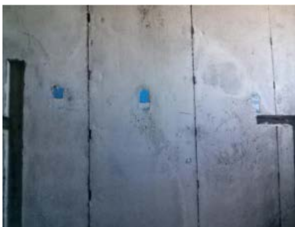
Figura 9 - Marcas da desforma;
