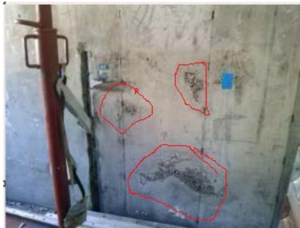
Figura 10 - Bolsões de segregação do concreto
