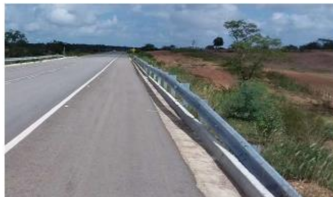
Figura 22 - Exemplo de Defesa Metálica Lateral
