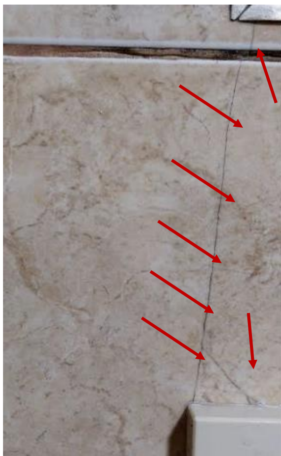
Figura 26– Manifestação patológica: Fissura
