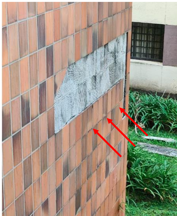
Figura 22 – Manifestação patológica: deslocamento
