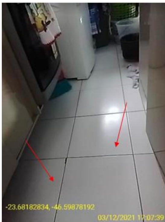
Figura 41 - Local a ser reparado
