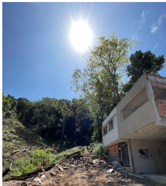
Figura 63 - Residência em estágio avançado de construção interditada pela Prefeitura
