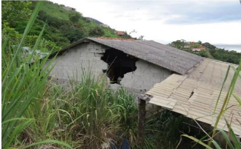
Figura 14 - Moradia Atingida por Bloco que Rolou na Encosta, no Bairro Morro do Abrigo, São Sebastião (SP)
