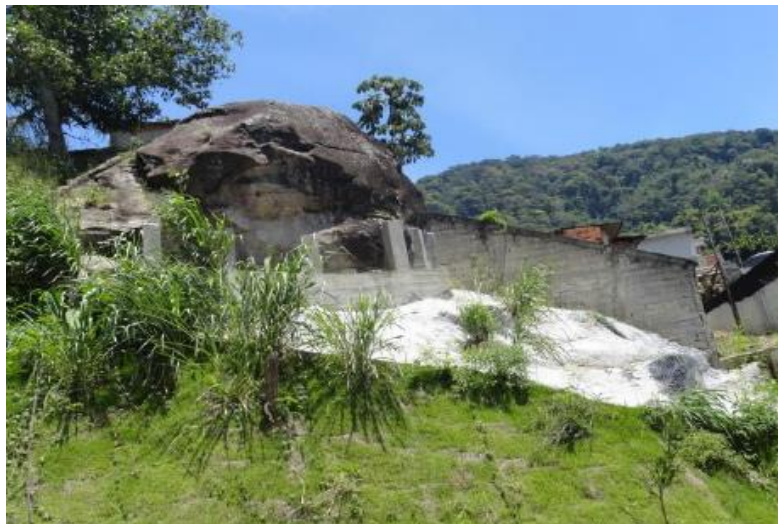
Figura 12- Bloco de Rocha Parcialmente Imerso na Matriz de Solo, com Obra de Contenção, no Bairro Itatinga, São Sebastião (SP)
