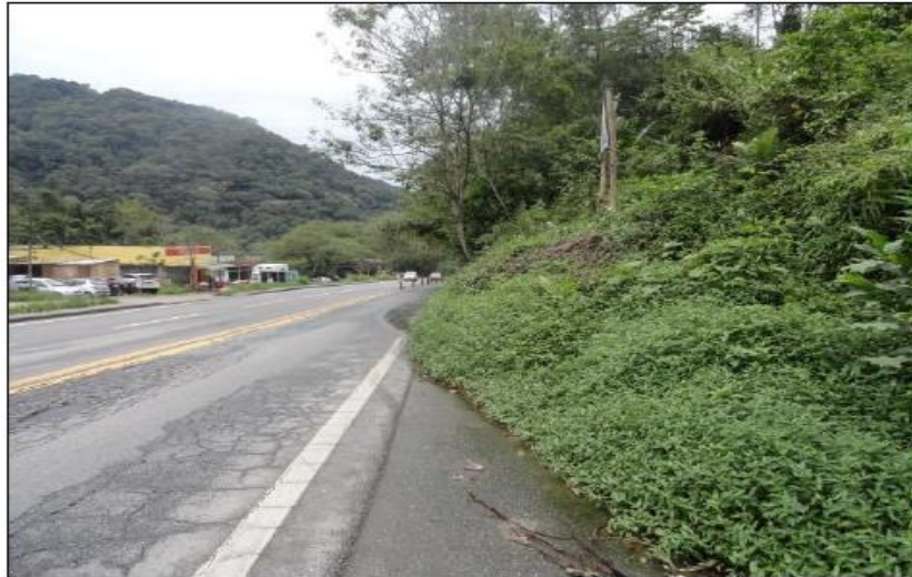
Figura 7- Vista Parcial do Depósito de Tálus Existente no Bairro De Juquehy, em São Sebastião, SP, que está em Movimento, Afetando A Rodovia
