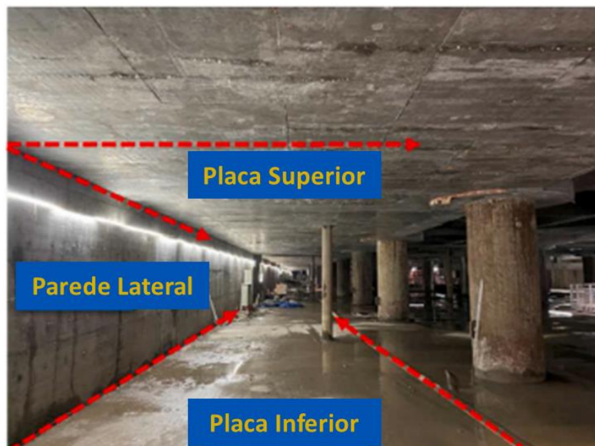
Figura 25 – Esquema da estrutura de obra subterrânea Fonte: Adaptado de DU, QIAN e XIE (2023, p. 2).
