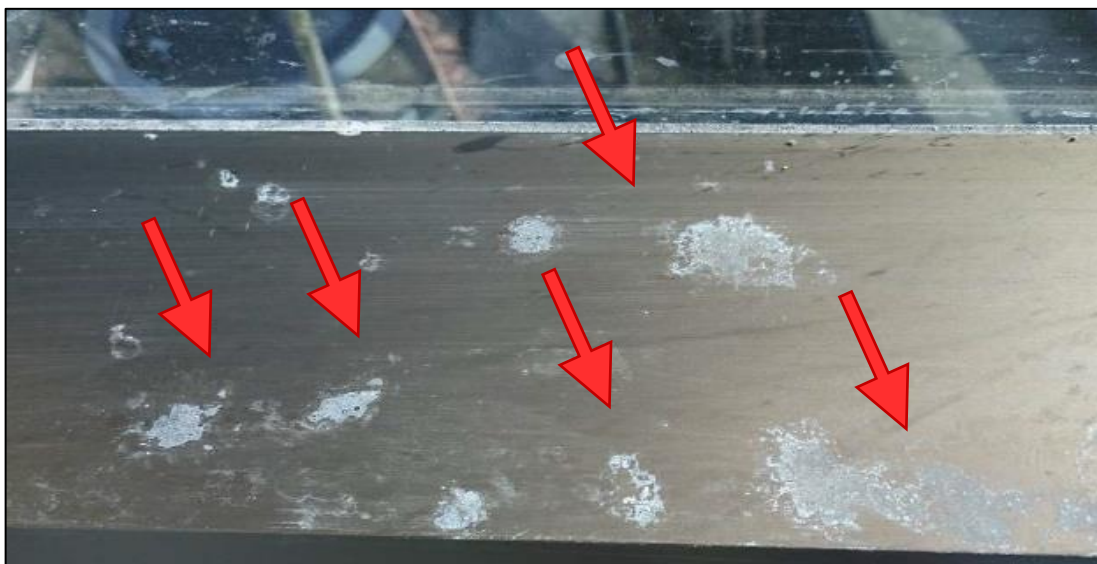
Figura 49 – Resquícios de argamassa na superfície do caixilho.
