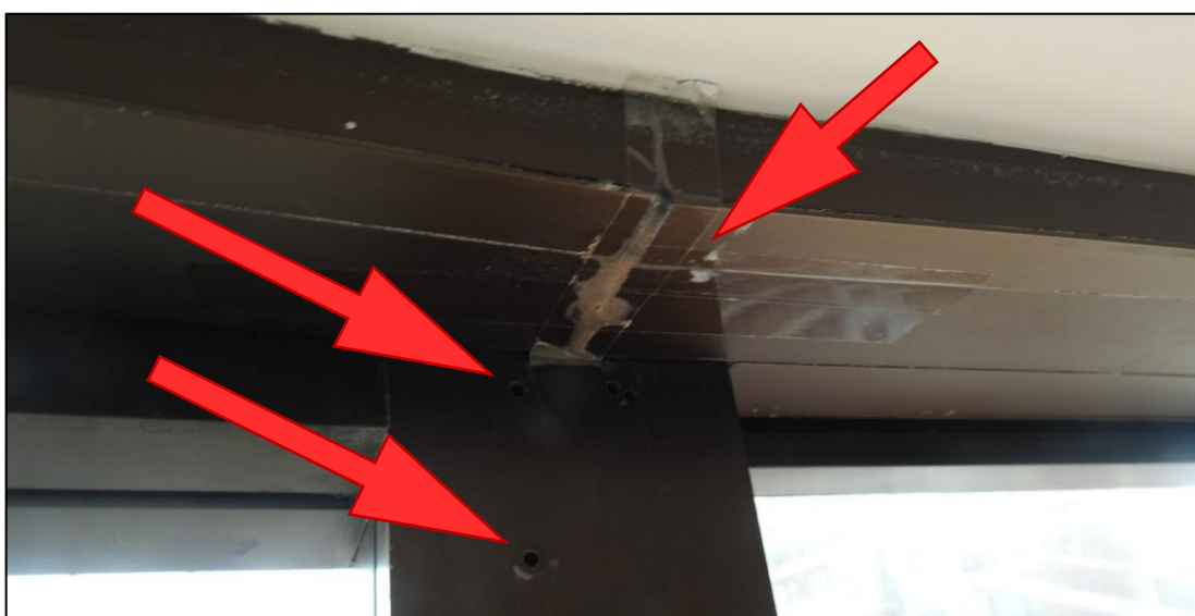
Figura 70 – Estrutura de alumínio do caixilho perfurado e rompido.
