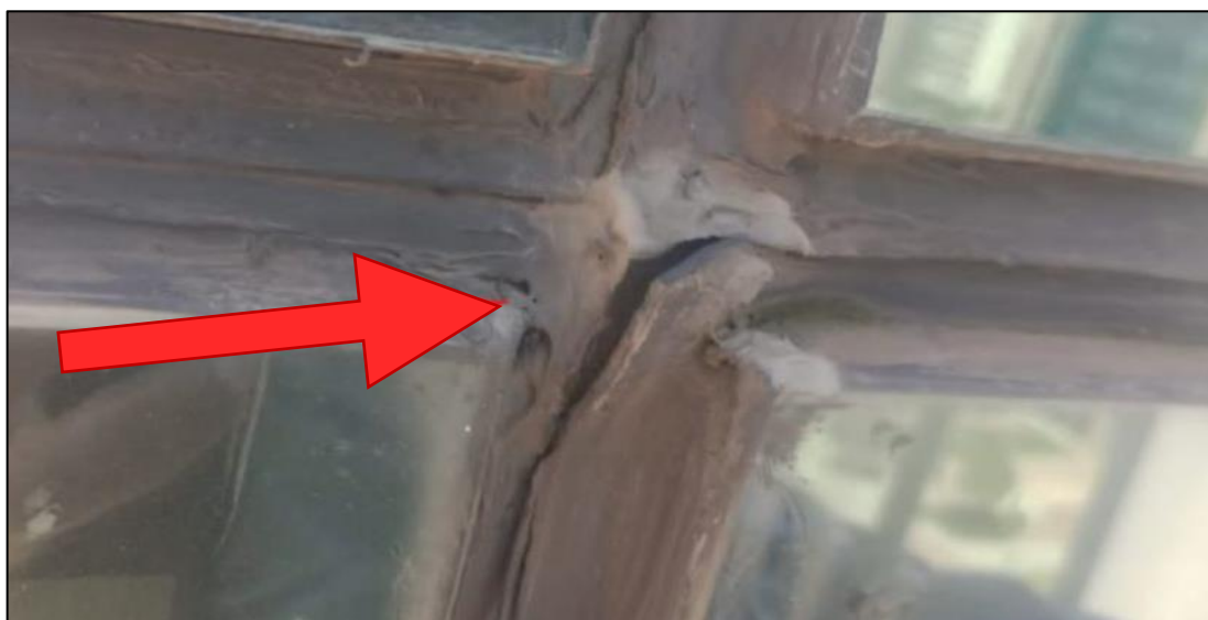
Figura 53 – Desgaste nas gaxetas externas.
