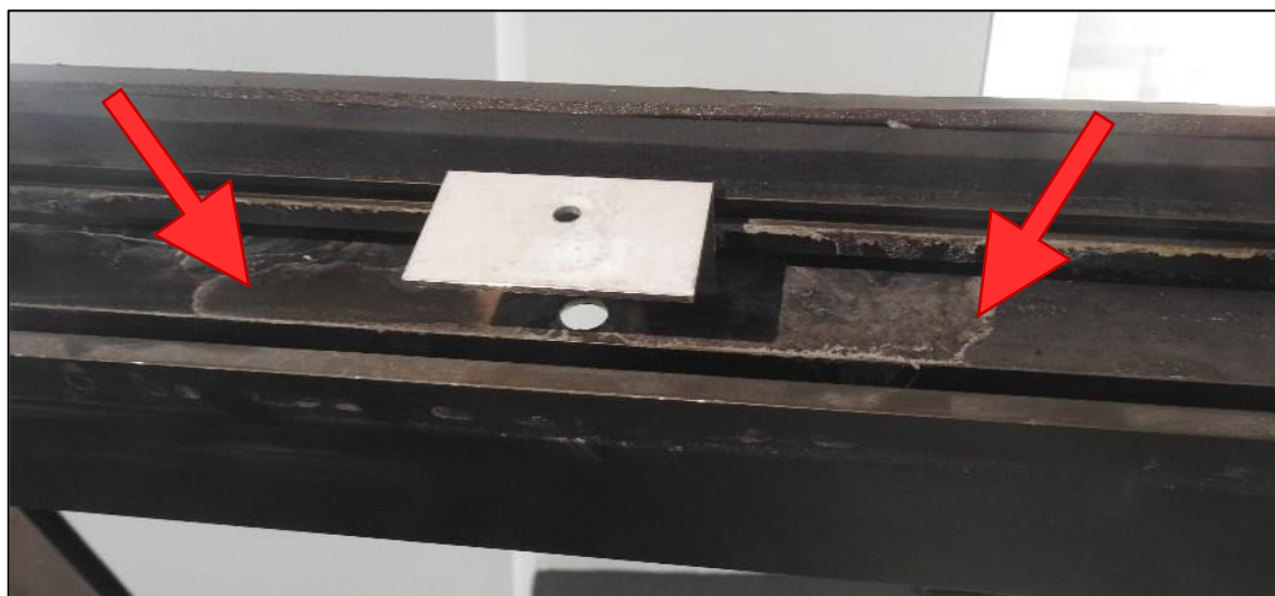
Figura 61 – Mancha de acúmulo de água, caixilho removido (I).
