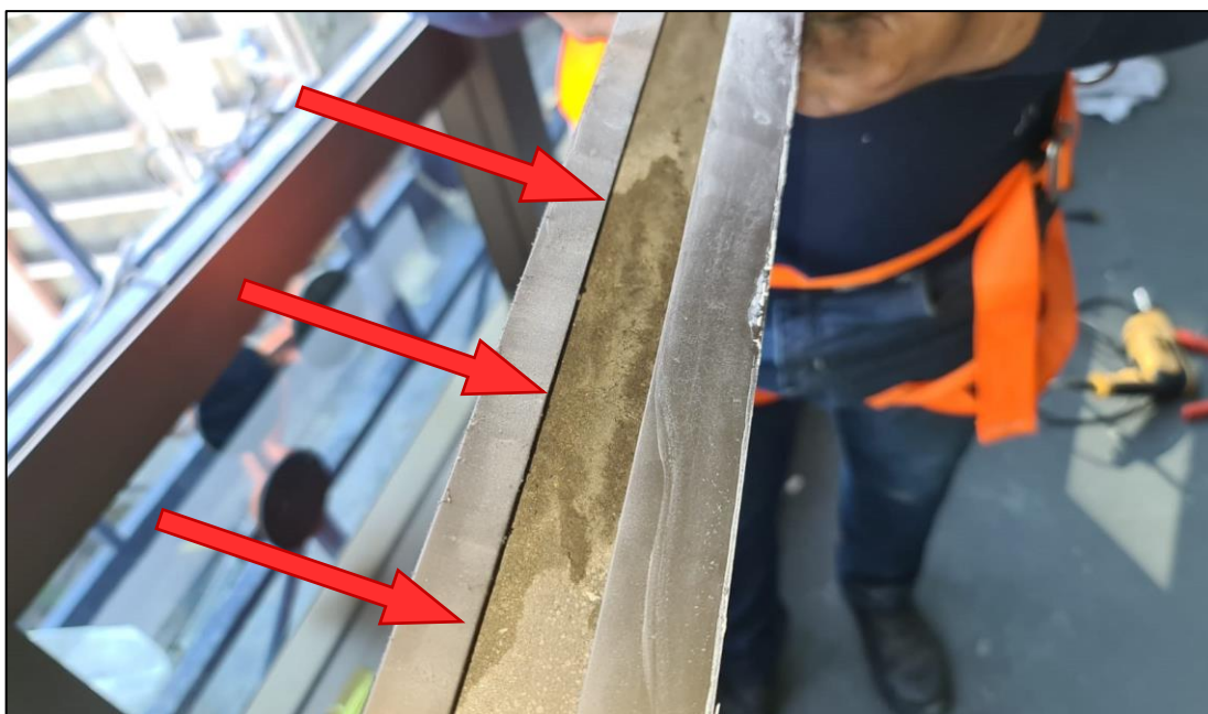
Figura 71 – Pontos de vulnerabilidades à infiltração.
