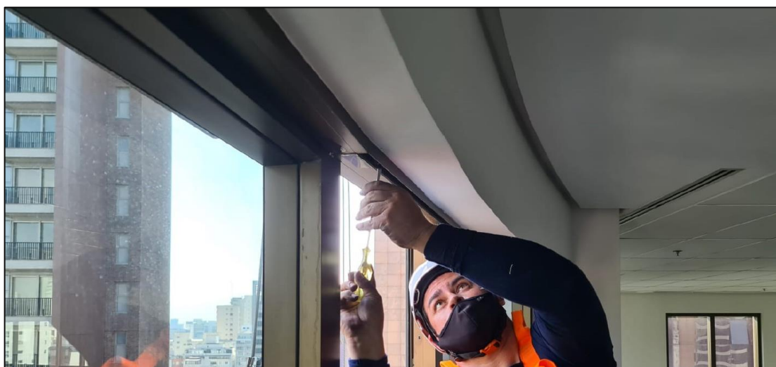
Figura 68 – Maxim-ar projetante sendo desmontado para avaliação (I).
