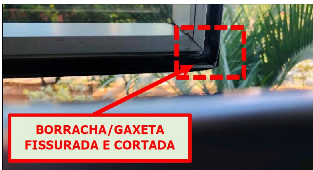
Figura 55 – Gaxeta/borracha fissurada e cortada.
