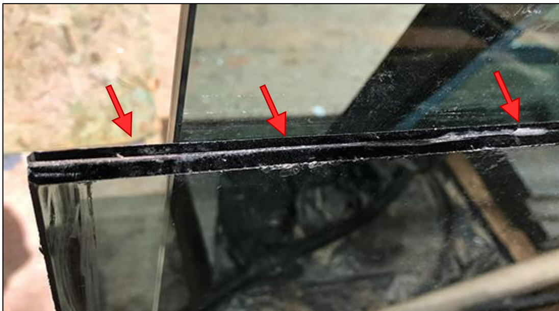
Figura 51 – Formação de micro trincas no perfil de vidro devido ao corte da peça sem ferramenta adequada.
