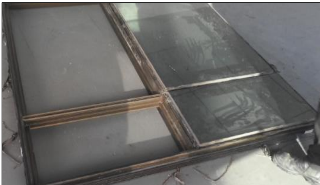
Figura 60 – Caixilho totalmente removido para inspeção.
