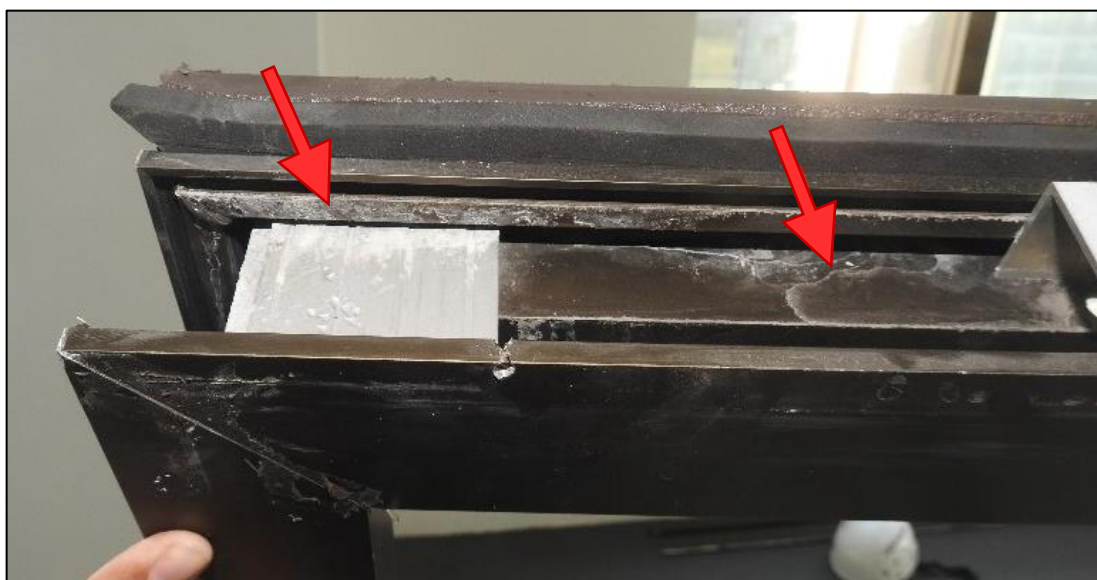
Figura 62 – Mancha de acúmulo de água, caixilho removido (II).
