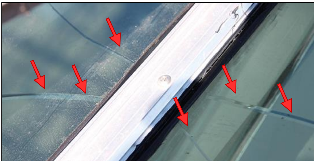
Figura 50 – Vidro fissurado devido ao contato direto do perfil de vidro com o parafuso de fixação.
