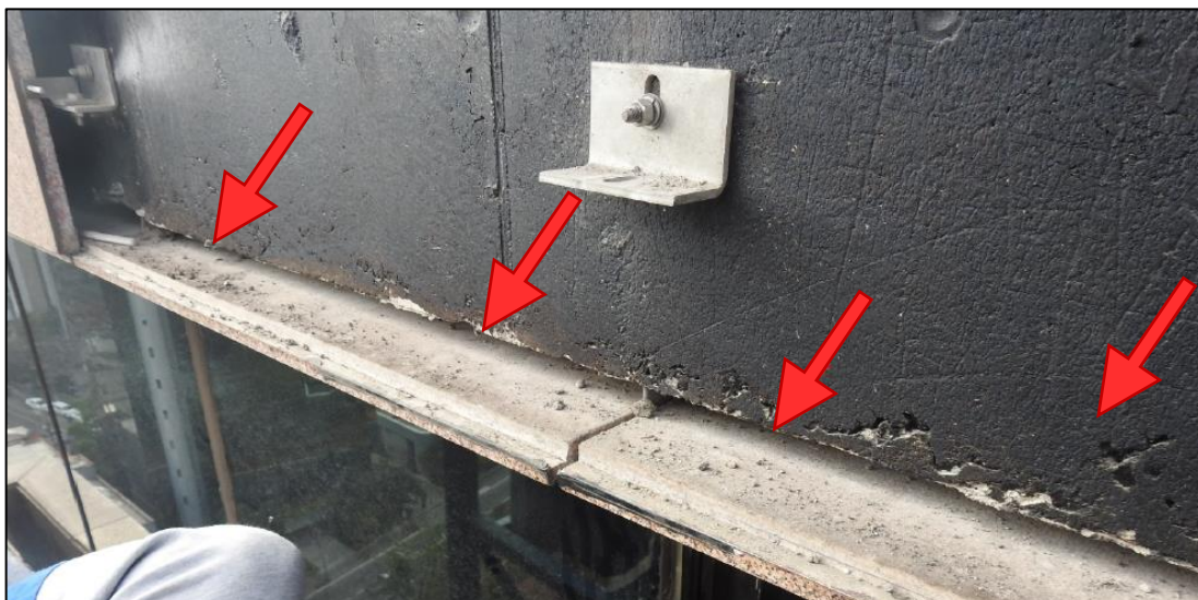
Figura 65 – Falta de elemento vedante na divisa das interfaces (I).
