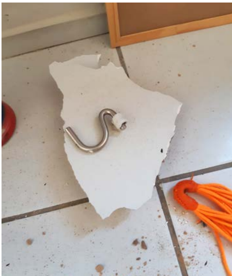
1. pedaço da parede que veio abaixo
