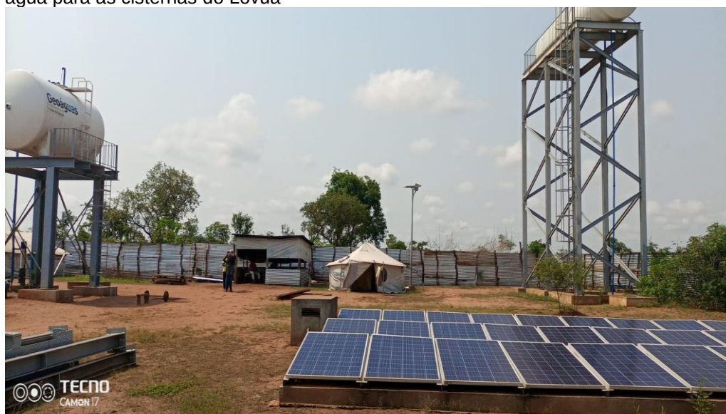
Foto 32 – Sistema de placas solares para geração de energia e bombeamento de água para as cisternas do Lóvua
