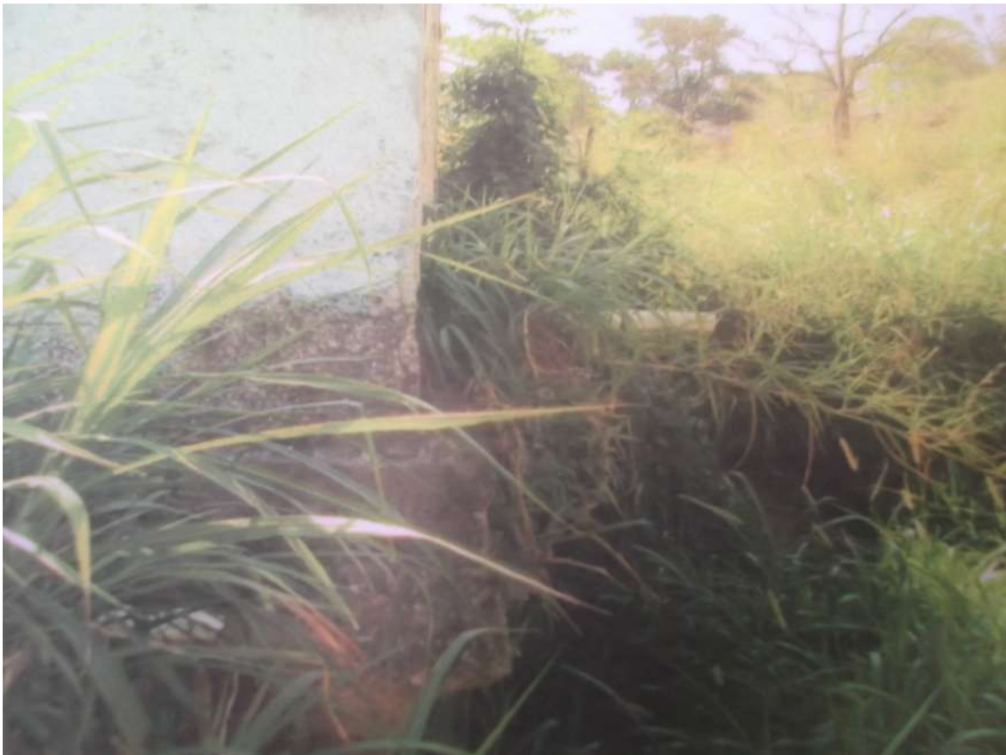
Imagem 14: O encanamento da escola Odaricoque despeja líquido diretamente no córrego (Silva 2013).
