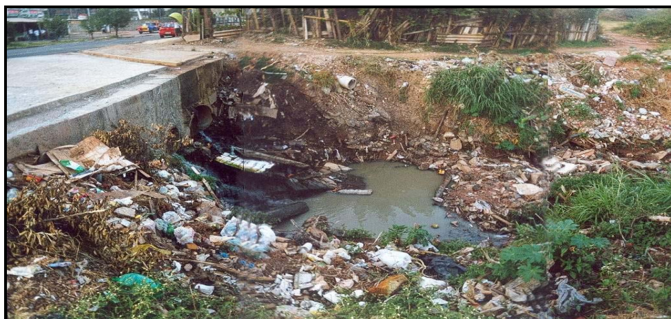
Figura 3.5- Interferência na drenagem
