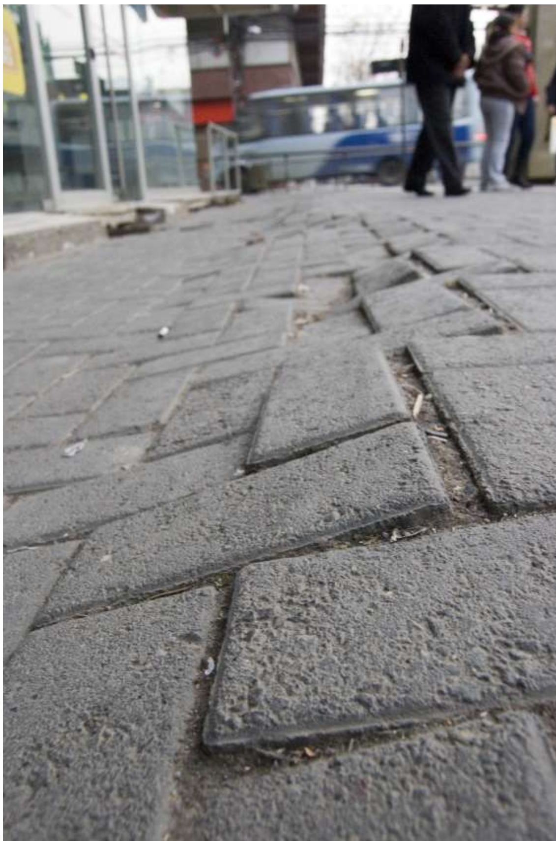
Figura 5. Alterações no asfalto em consequência do terremoto de 27 de Fevereiro de 2010, Concepción, Chile. (Mihara, T., 2011)
