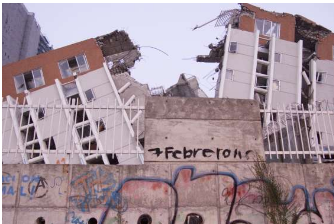
Figura 10. Edifício mantido conforme seu desabamento no terremoto de 27 de Fevereiro de 2010, Concepción, Chile. (Mihara, 2011)
