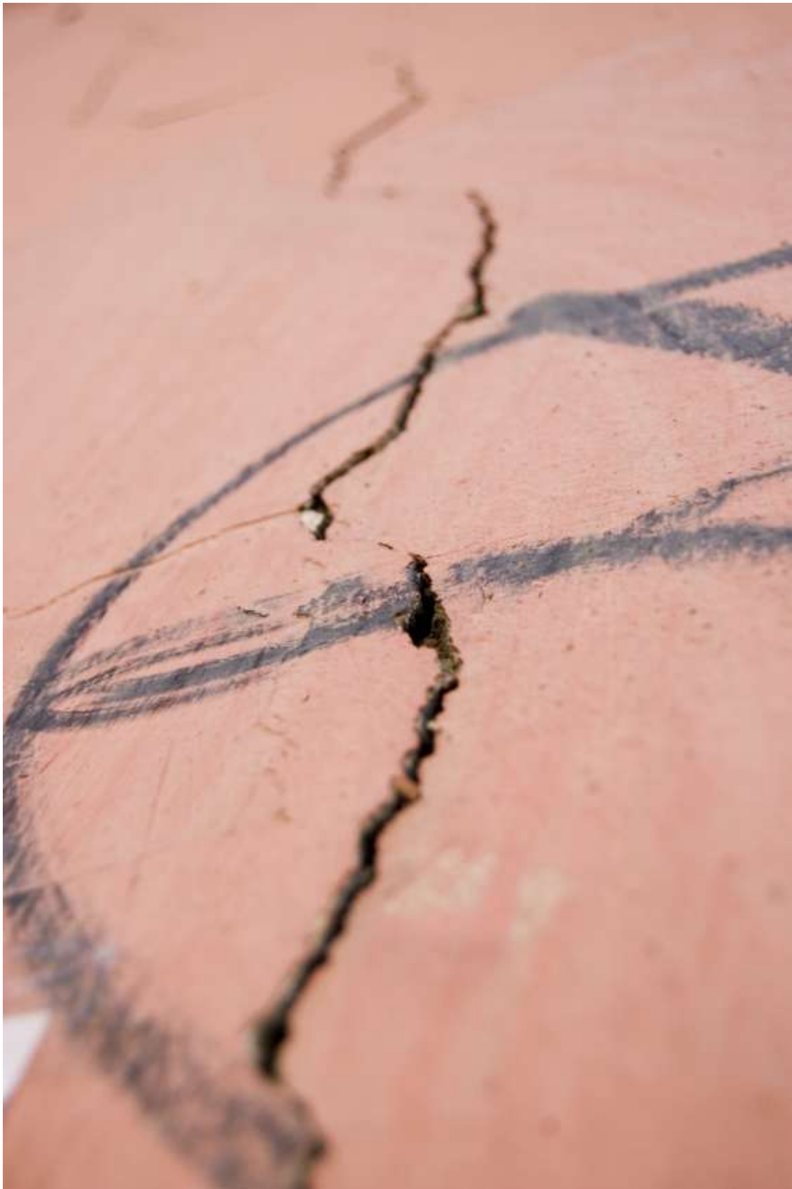
Figura 1. Detalhe de rachadura externa causada por terremoto em residência. Bairro Brasil, Santiago, Chile. (Mihara, 2011)
