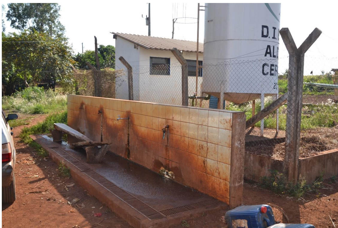
Figura 19 - Estrutura para disponibilização de água na TI Cerro'í
